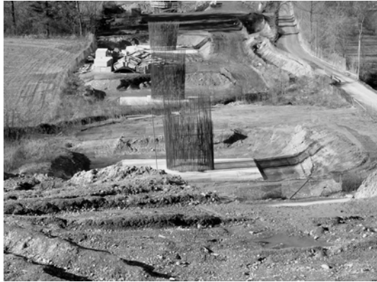
Cantiere in abbandono sulla linea Arcisate-Stabio.
